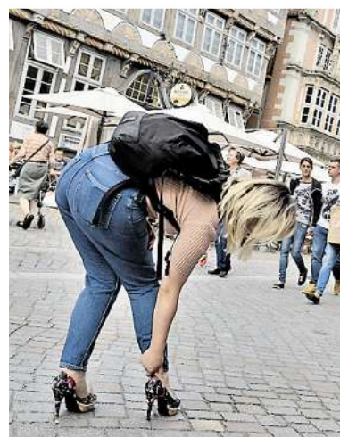
Ausgeschwemmte Fugen: Das Pflaster wurde schon zur Stolperfalle.
